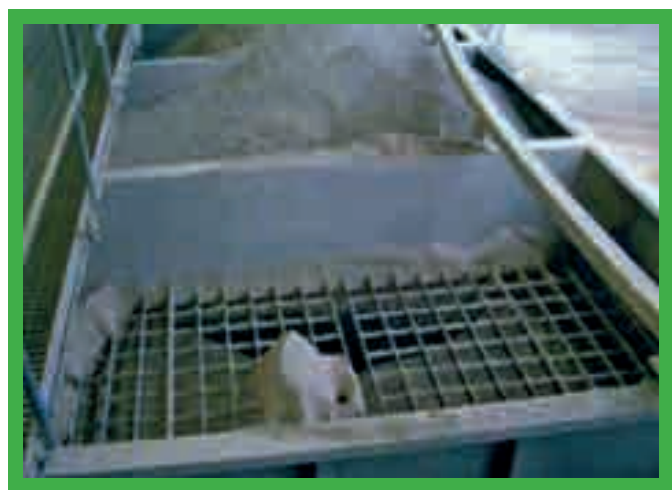
Zainstalowane kraty zabezpieczające.
