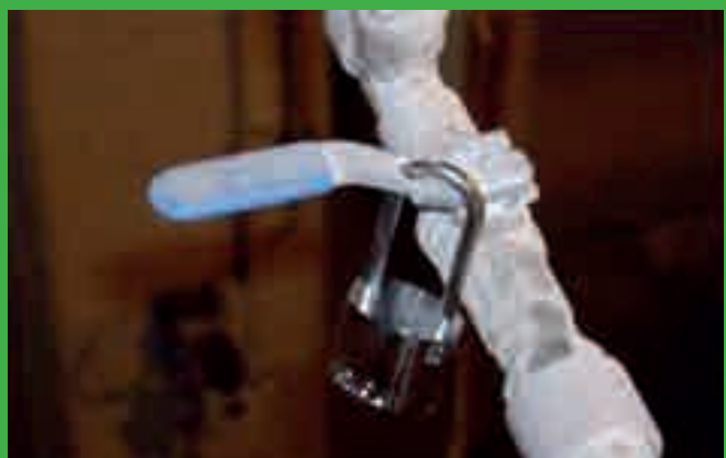
Zablokowanie zaworu energii pneumatycznej.
